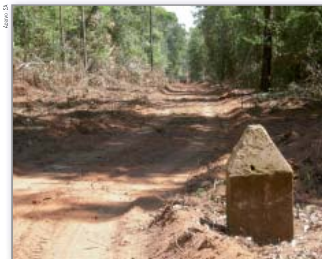
Limpeza de trecho de 26 Km de picada demarcatória do PIX, entre os rios Kurizevo e o Tatuari, com utilização de trator esteira
